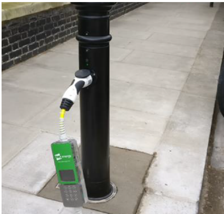
Rys. 16. Punkt ładowania w osobnym słupku podłączonym do instalacji lampy ulicznej w dzielnicy Lewisham
