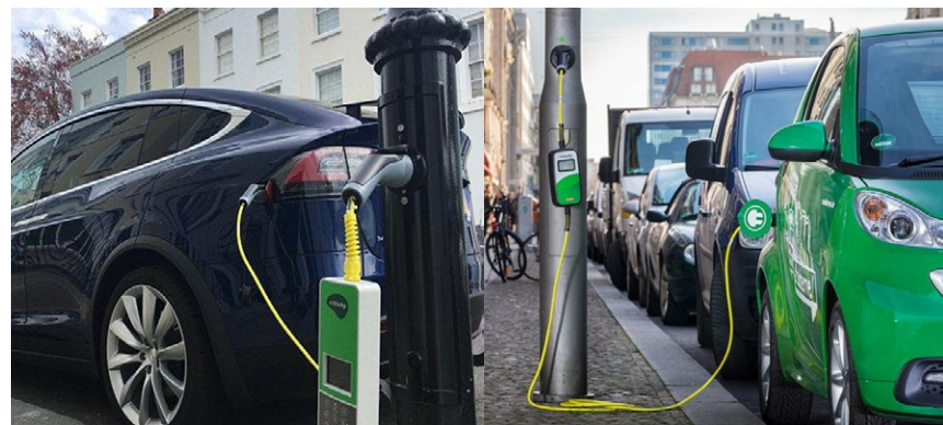
Rys. 15. Przykładowe instalacje punktów ładowania w lampach ulicznych w Londynie
