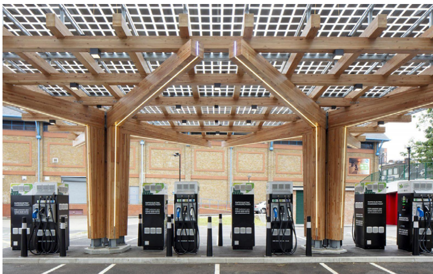
Rys. 14. Przykład hubu szybkiego ładowania zrealizowanego przez TfL w londyńskiej dzielnicy Woolwich
